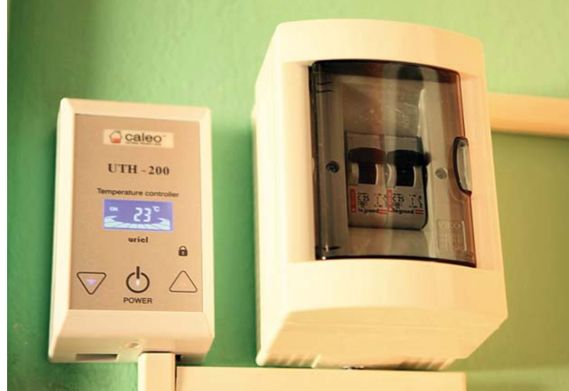
Рис. 26. Терморегулятор, подключенный к сети через отдельный автомат
